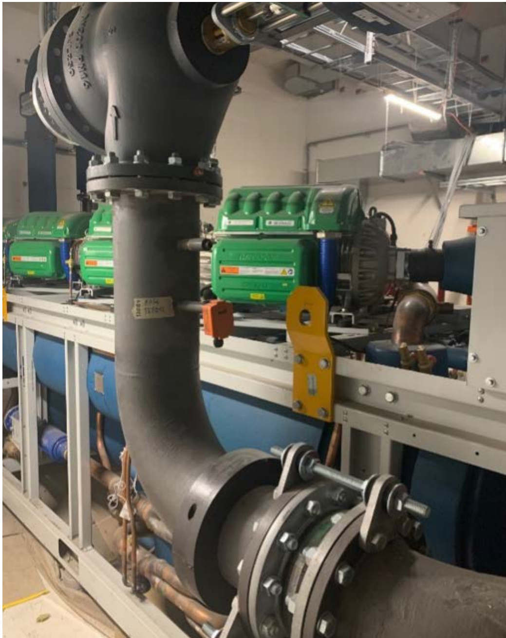
Kältemaschine im Geschoss U2
